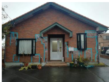
地震発生当時の建物の状況 (大雨の前にビニールで保護)
